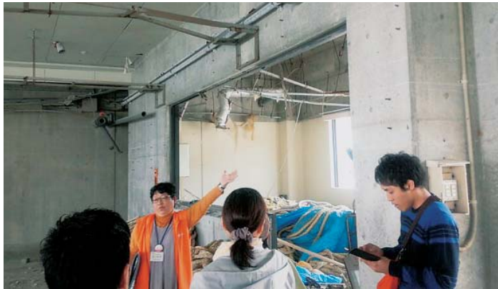
津波で被害を受けた漁協の施設内部
